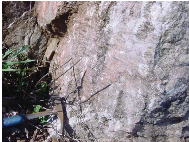
Fotografía 4. Estrías de falla en mármoles.
